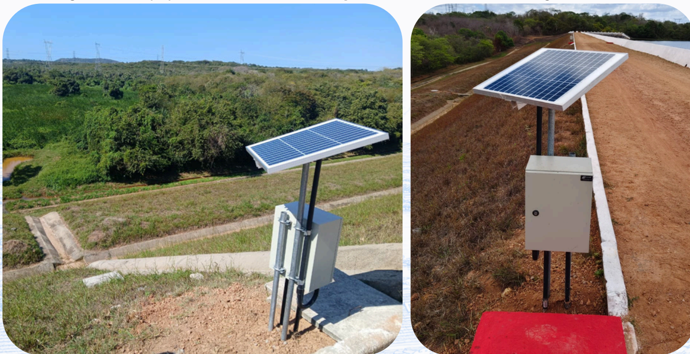
Figura 3 - Equipamentos de Automação das Leituras na Barragem Gavião
